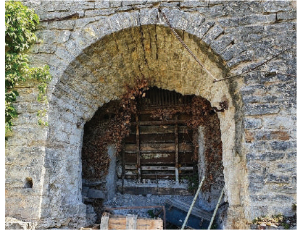
Une sortie d'un four avec des grilles en hauteur, pour faire descendre la chaux fabriquée, 2022
