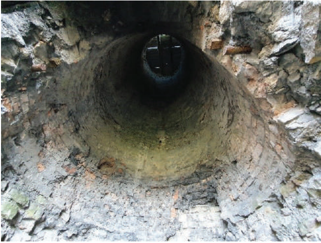
L'intérieur du ventre d'un four, avec en haut, le « gueulard », 2022
